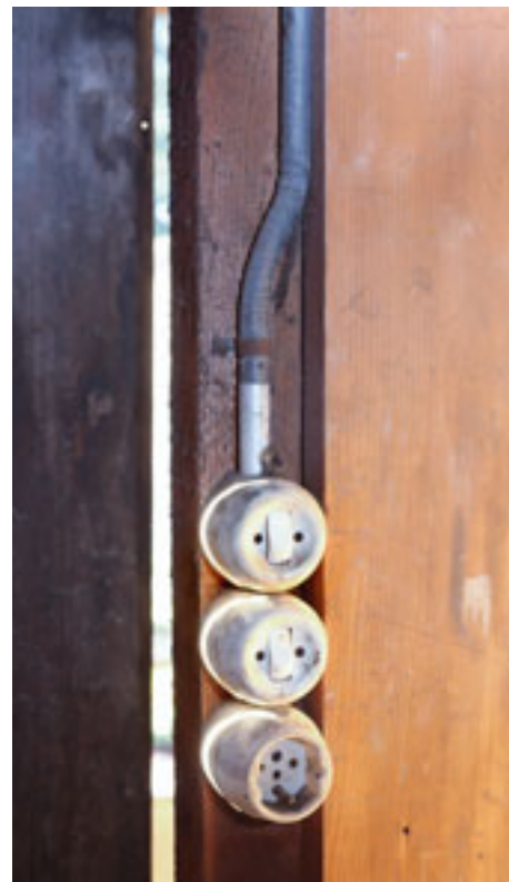
Alte Elektroinstallationen mit einem Fehlerstrom-Schutzschalter nachzurüsten, ist empfehlenswert, auch wenn dazu keine gesetzliche Pflicht besteht.
